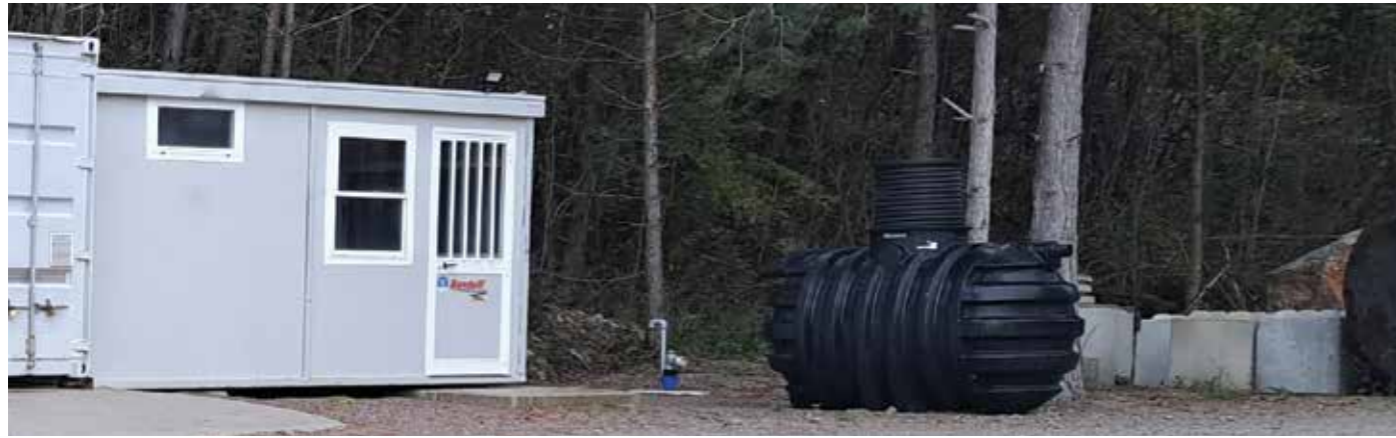
Sanitarni kontejner z agregatom in greznico (foto: Jože Stopar).
