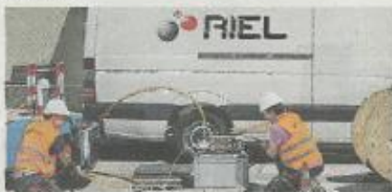
Nella foto tratta dal sito di Riel, lavori di posa di fibra ottica
